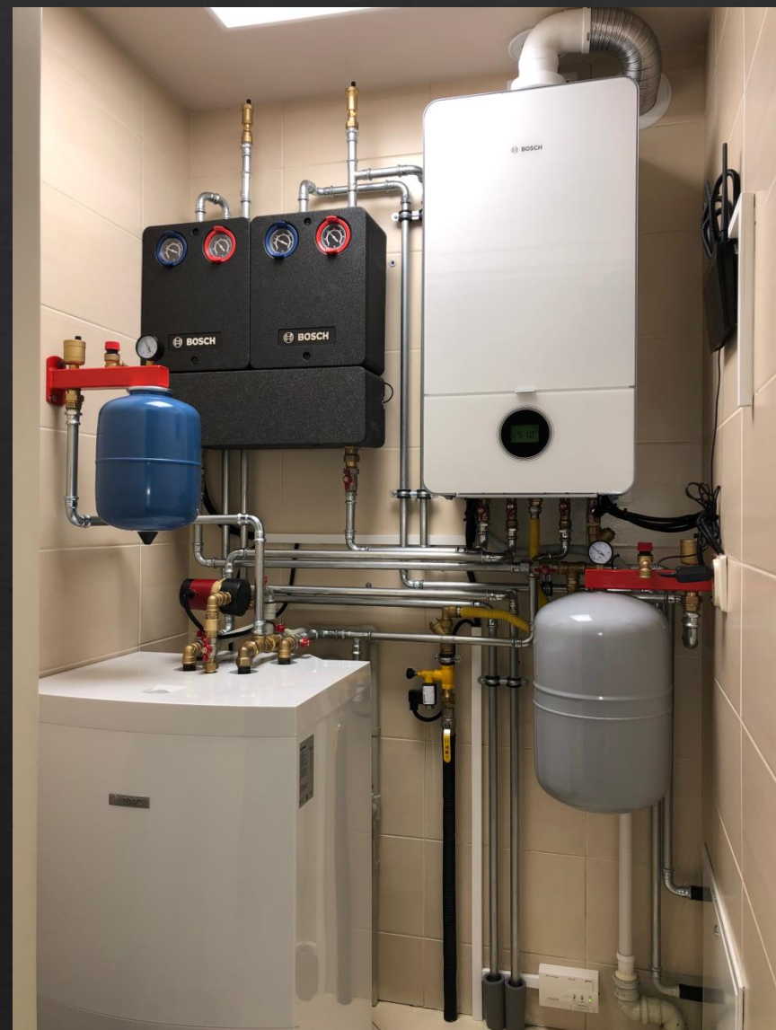
Rys. 40 Kocioł zasilany gazem płynnym; https://www.chemline.pl
