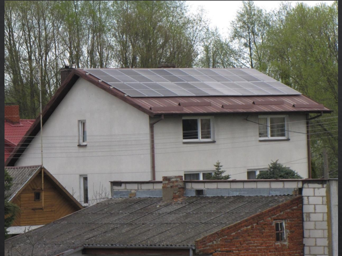
Rys. 42 Instalacja fotowoltaiczna na dachu domu przy ulicy Polnej. Fotografia własna
